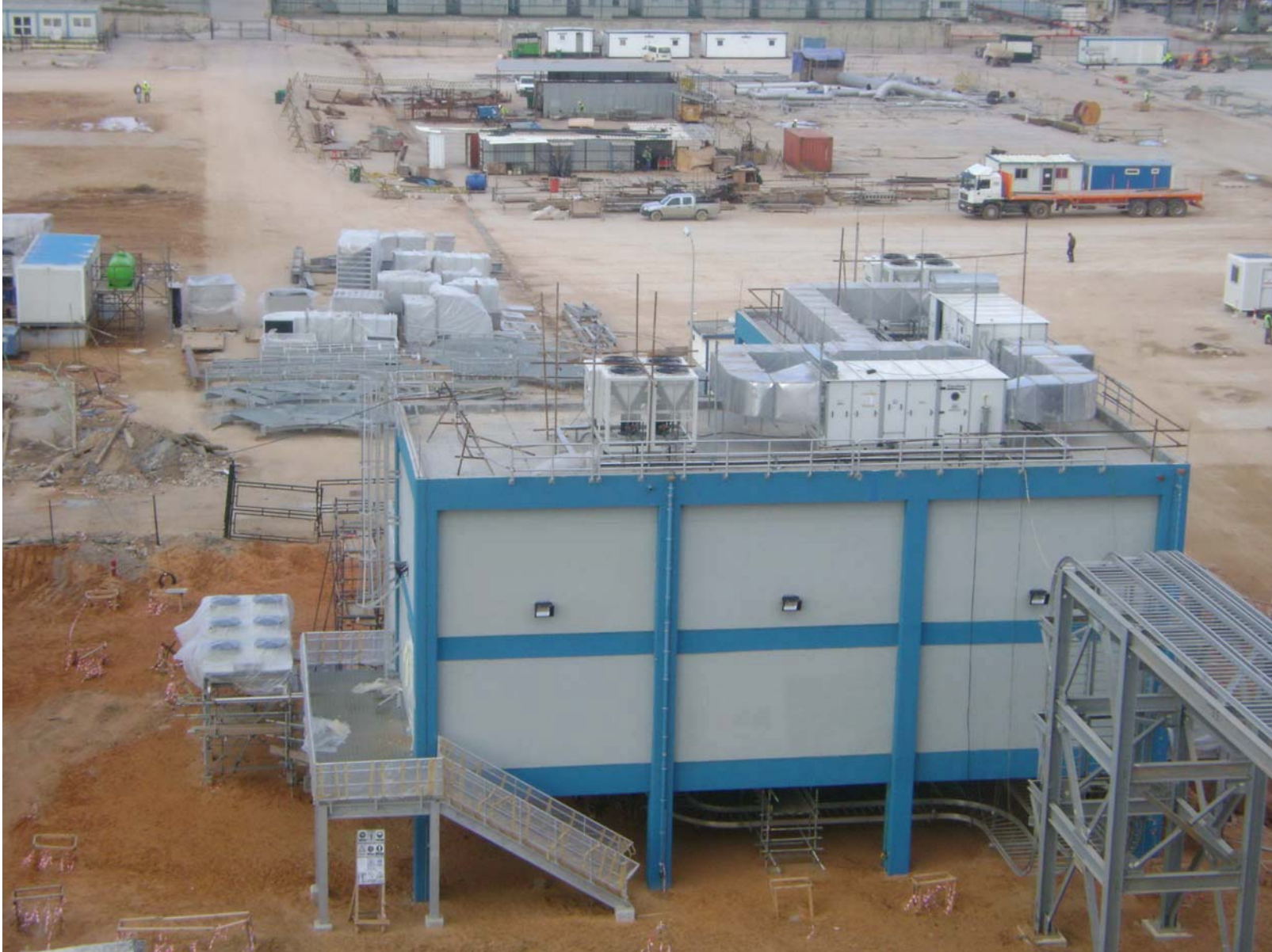
New LNG Train -Skikda Algeria
