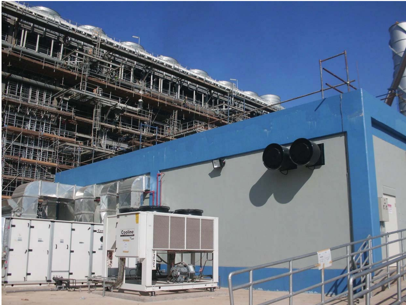
New LNG Train -Skikda Algeria
